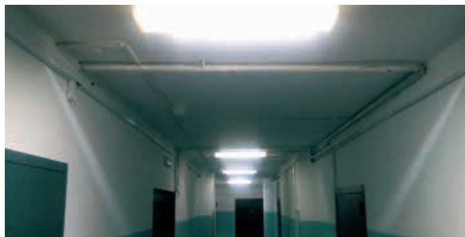
Фото 1. Антивандальные энергосберегающие светильники, срабатывающие на шум, установлены на всех межквартирных площадках жилого дома № 36
